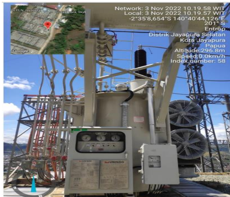
Gambar 2.2 Transformator Daya (Sumber: Gardu Induk Skyline, Jayapura)
