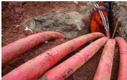
Gambar 2. 5 Saluran Kabel Tegangan Menengah
