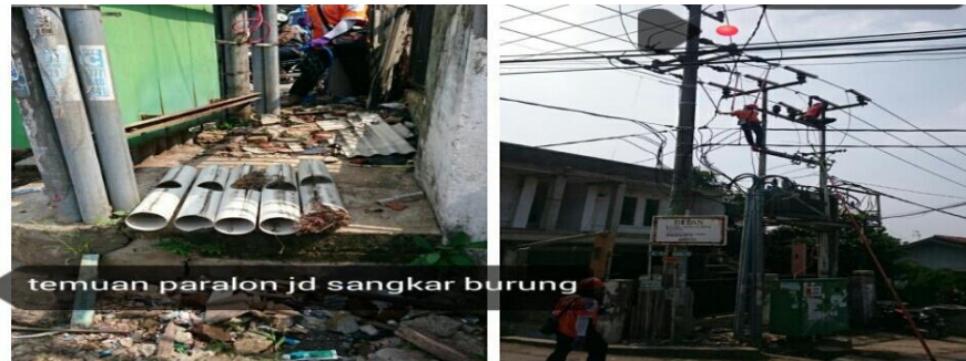
Gambar 2.10 Gangguan akibat sarang burung
