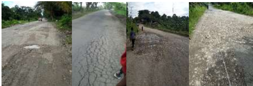
Gambar 1. 1 Kerusakan Jalan Ruas Sorong-Klamono
