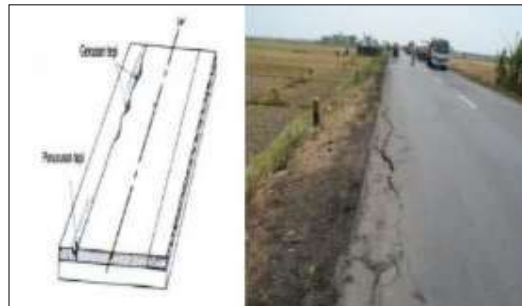
Gambar 2. 19 Retak Samping Jalan ( Edge Cracking )
