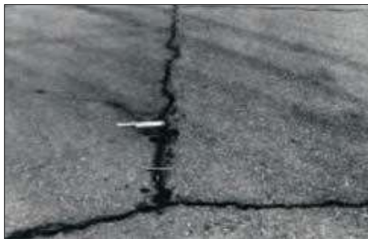
Gambar 2. 21 Retak Sambung (Joint Reflec Cracking)
