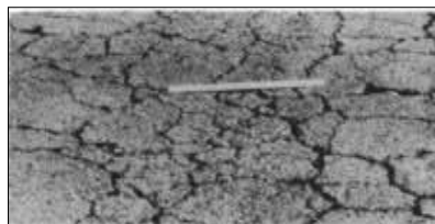
Gambar 2. 7 Retak Kulit Buaya ( Alligator Cracking )
